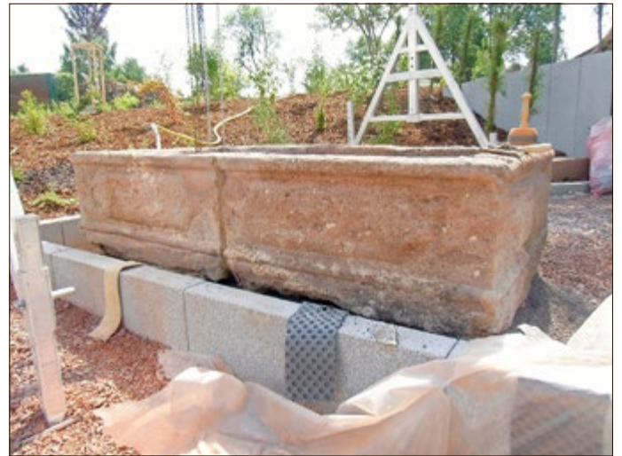
Aufbau des sanierten Schulbrunnens, Juni 2013 (Dorfchronik)
